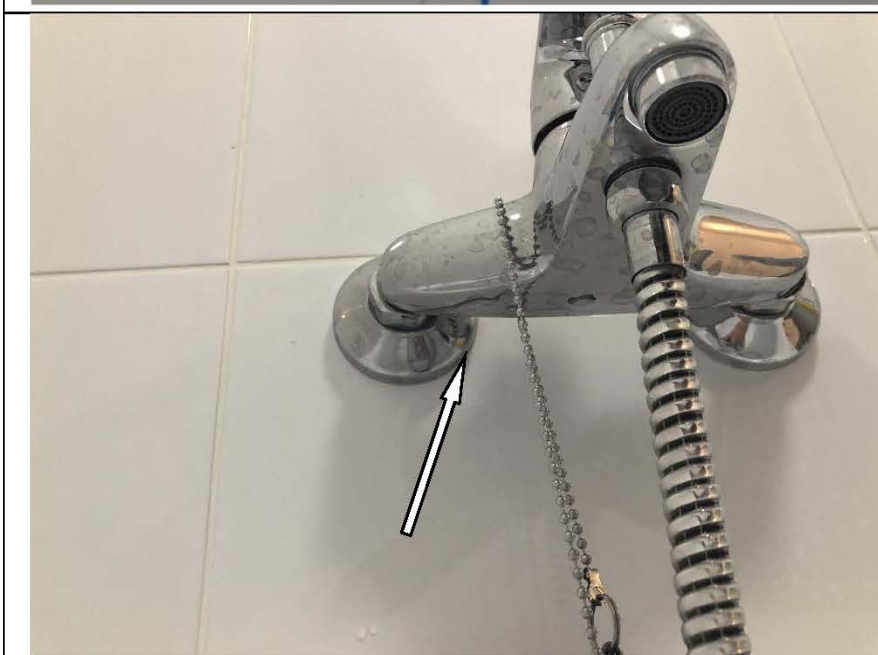
Фото №48. Следы протечки арматуры смесителя в ванной комнате.
