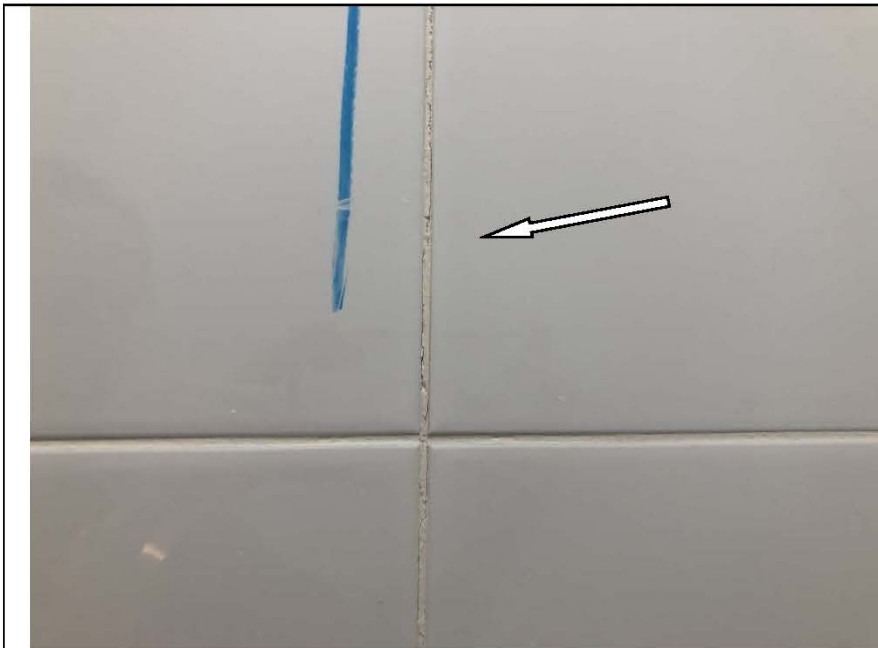
Фото №49. Трещины в затирке настенной плитке в санузле.
