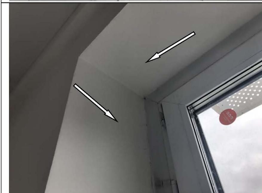
Фото №30. Откосы оконного блока в спальне выполнены с дефектами.
