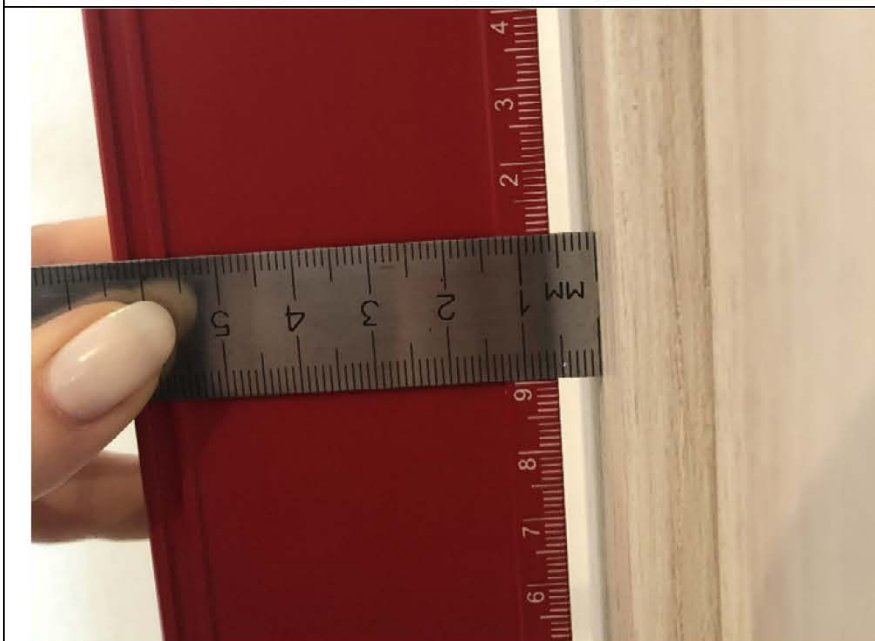
Фото №23. Измерение отклонения дверного наличника в санузле.
