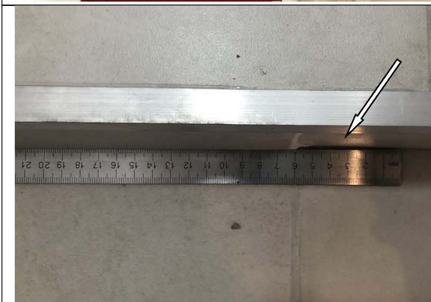
Фото №24. Дефект дверного порога в санузле в квартире.
