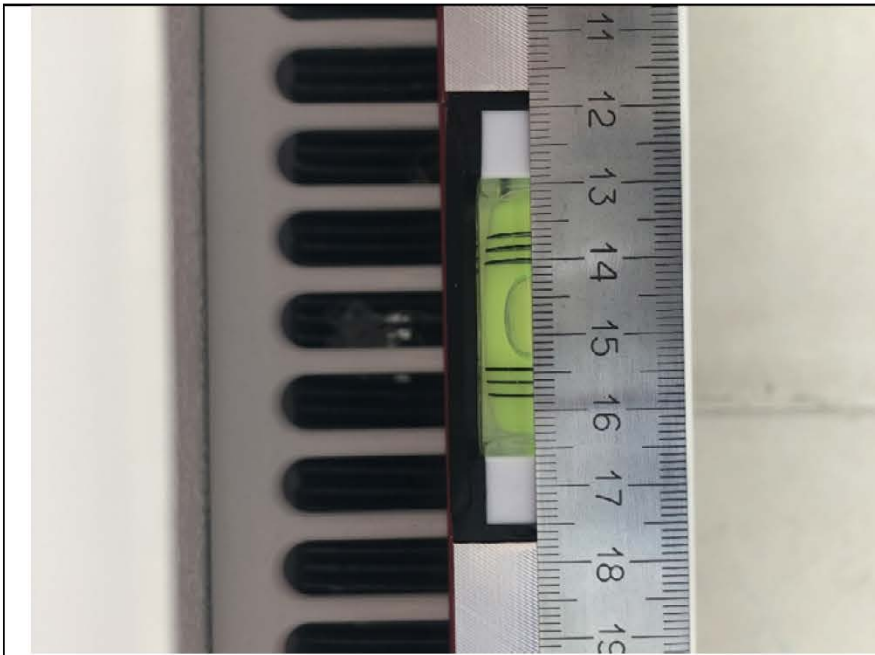
Фото №22. Отопительный прибор в спальне смонтирован неровно.
