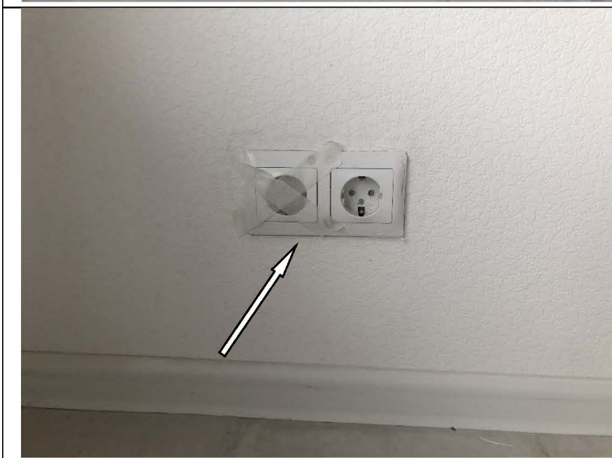
Фото №33. Дефект розетки в кухне.
