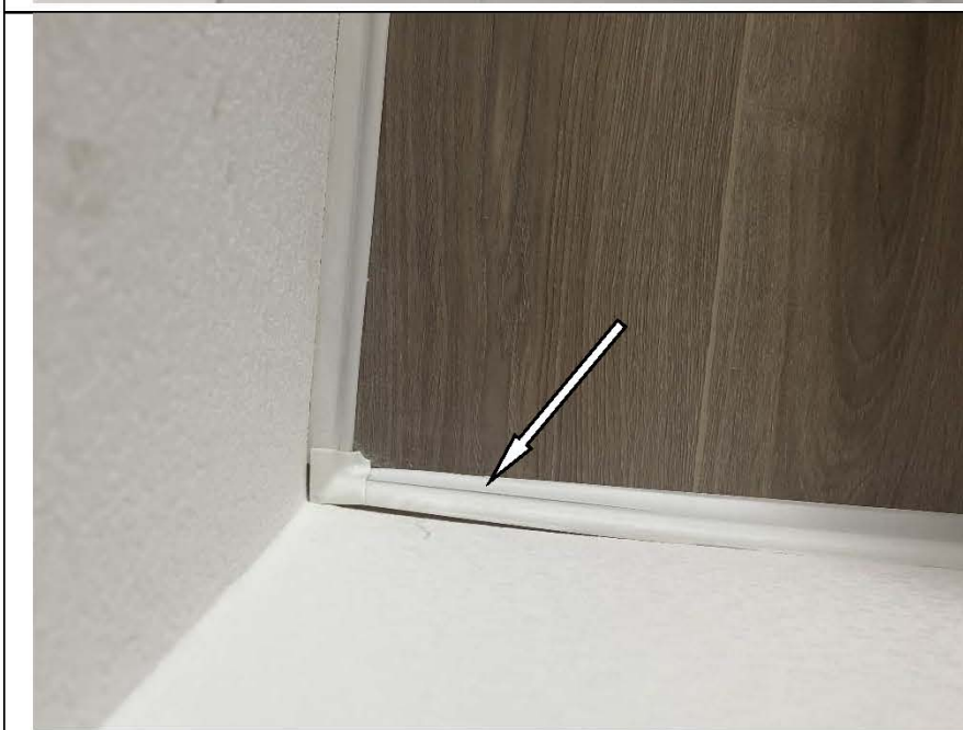
Фото №51. Напольный плинтус ПВХ неплотно прилегает к стене в спальне.
