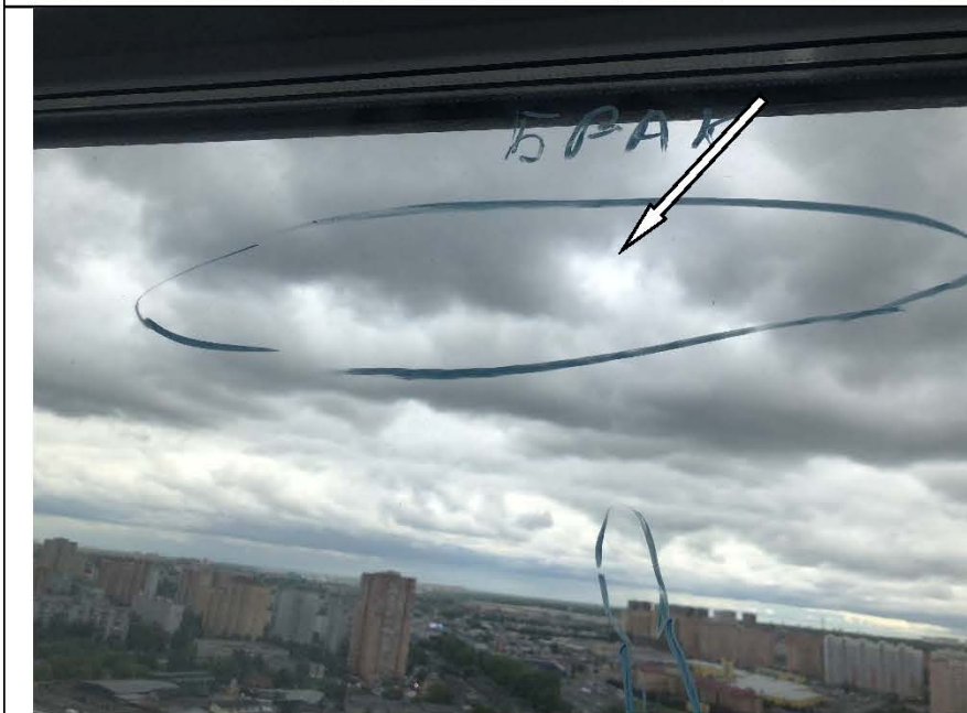
Фото №41. Царапины на стеклопакете оконного блока в спальне.
