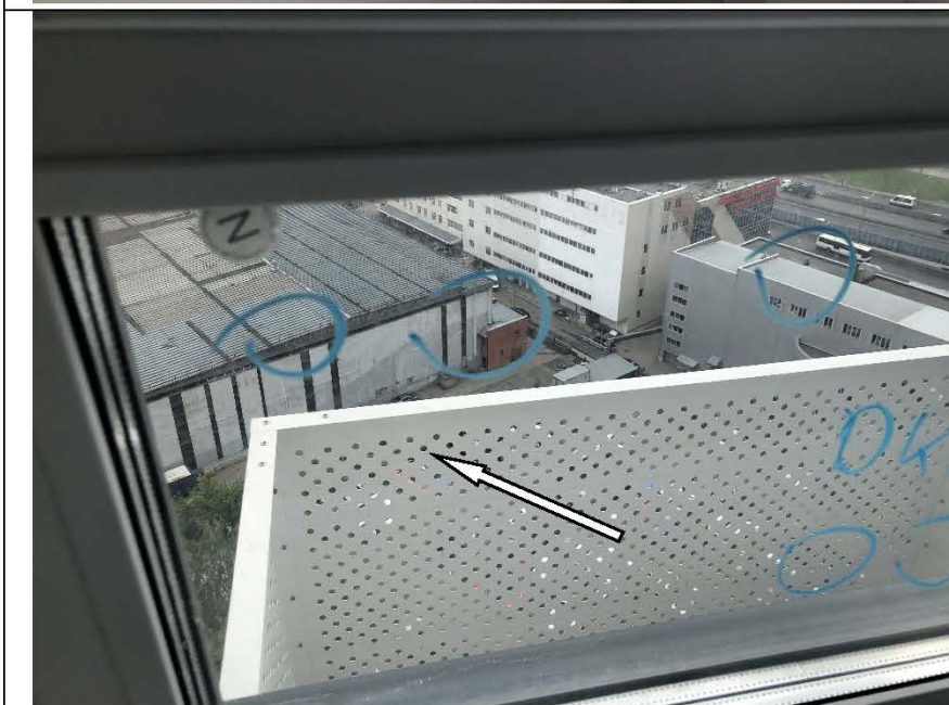
Фото №27. Царапины, окалины на стеклопакете оконного блока в кухне.
