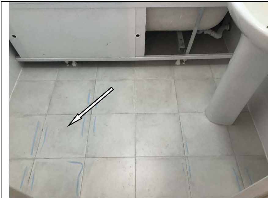
Фото №7. Общий вид напольного покрытия в санузле в квартире. Дефект плитки.
