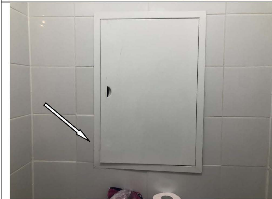
Фото №38. Дефект сантехнического люка в санузле в квартире.
