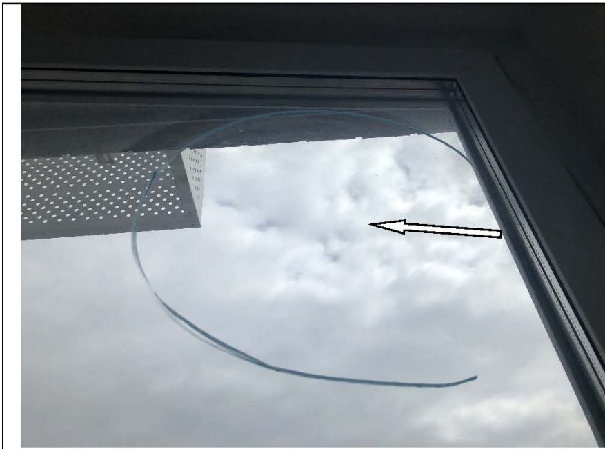
Фото №28. Царапины на стеклопакете оконного блока в кухне.
