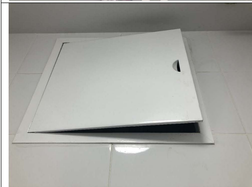
Фото №39. Дефект сантехнического люка в санузле в квартире.
