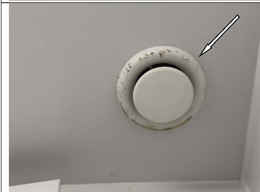
Фото №50 Диффузор вытяжки загрязнен.
