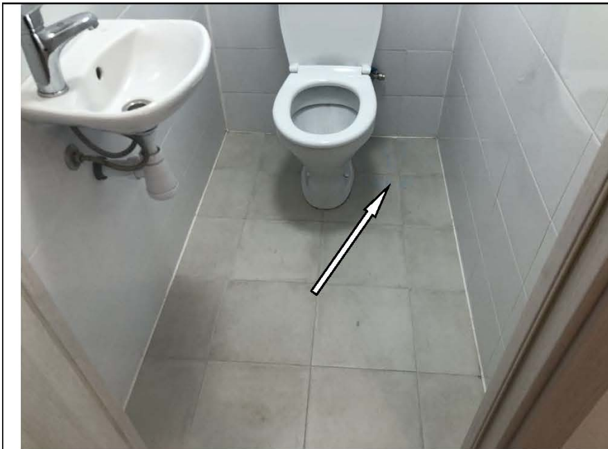
Фото №4. Общий вид напольного покрытия в санузле в квартире. Дефект плитки.
