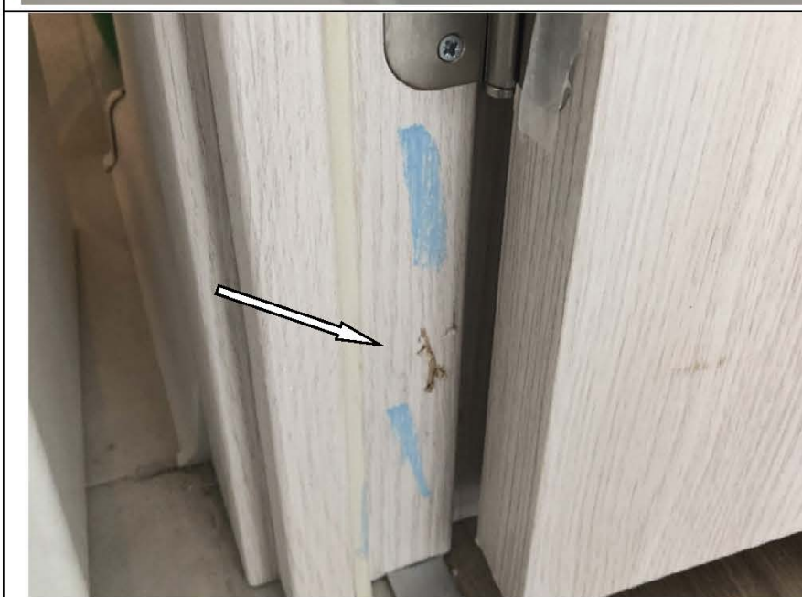
Фото №45. Дефекты дверной коробки в спальне.
