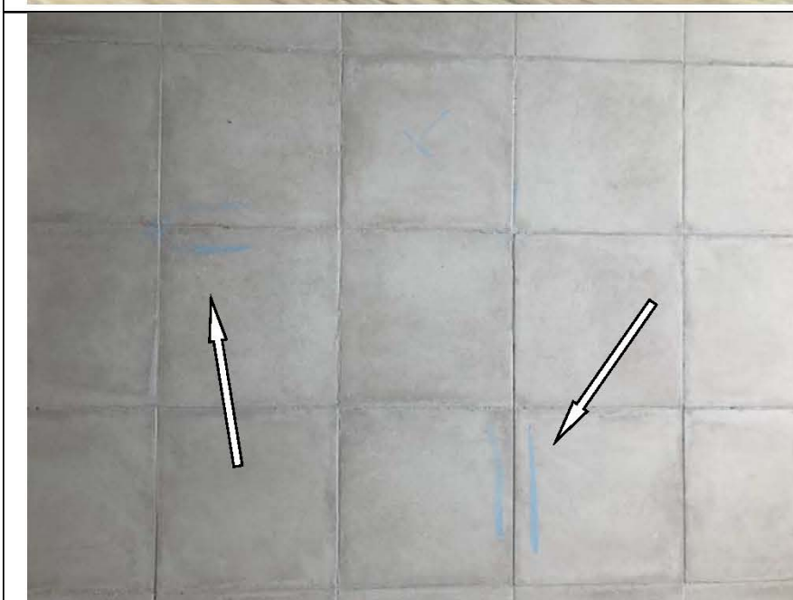
Фото №21. Неполное заполнение шовного пространства затирочным составом в кухне в квартире.
