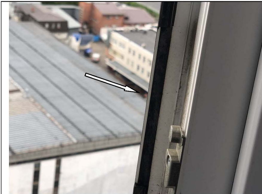
Фото №43. Отсутствует часть уплотняющей прокладки.
