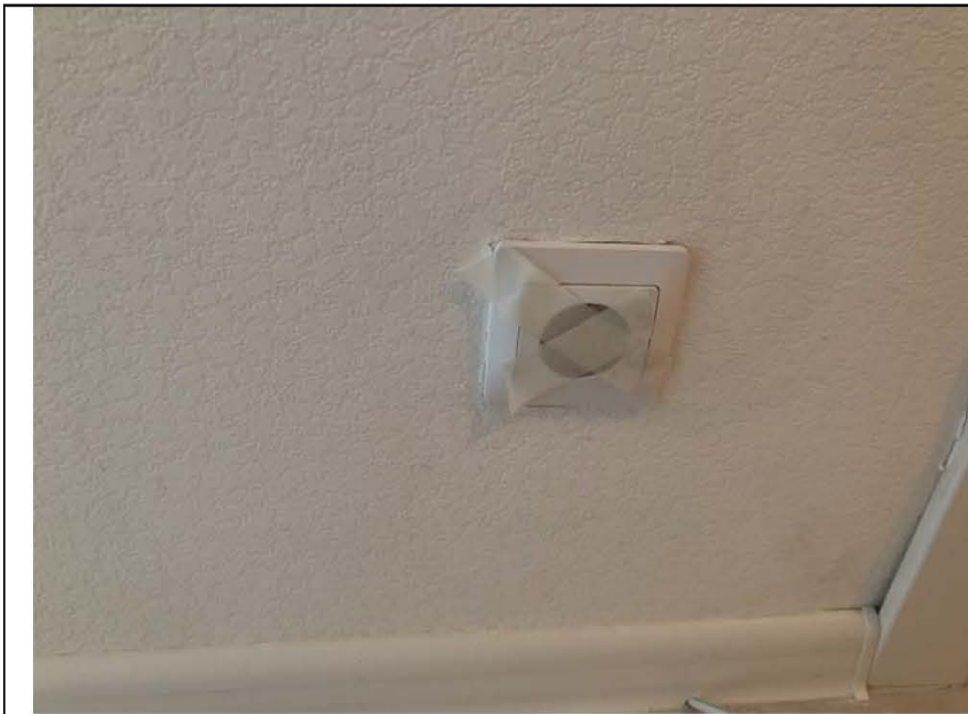
Фото №37. Дефект розетки в коридоре.
