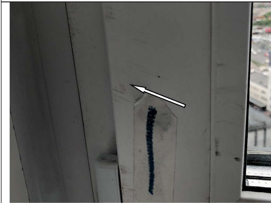
Фото №29. Дефект профиля ПВХ оконного блока в кухне
